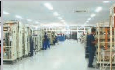
Linha de Montagem de Painéis de Controle e Força
